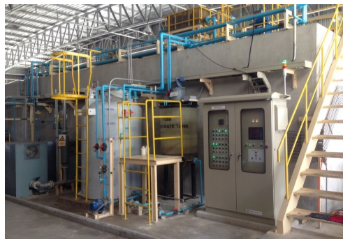
排水処理装置
