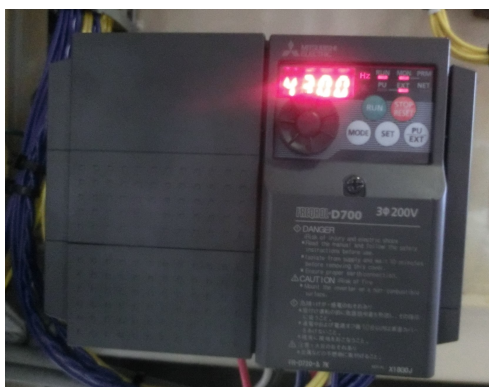
循環ポンプ取付インバーター
