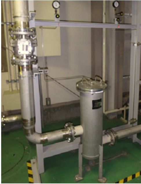
コンプレッサーフィルタ（改修前）
