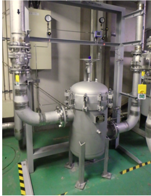
コンプレッサーフィルタ（改修後）
