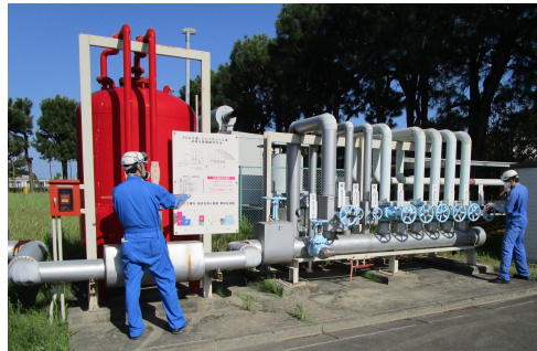
泡消火設備操作訓練
