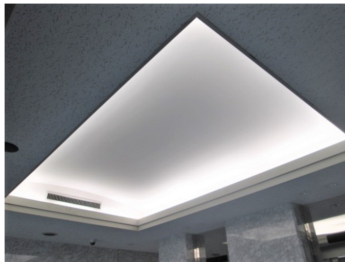
LED化されたエントランス照明
