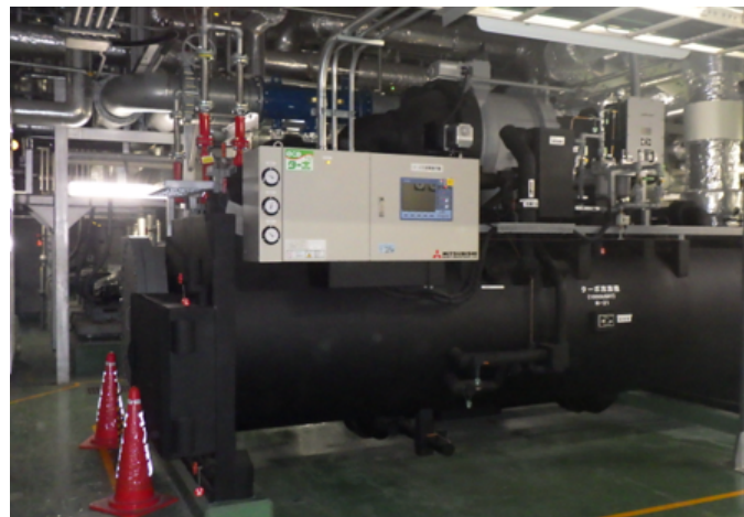
ターボ冷凍機全景
