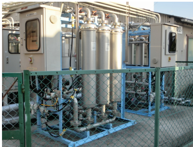
排水回収再利用設備
