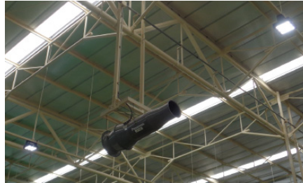
ジェットファンと天井の採光窓
