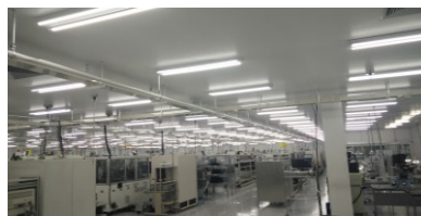
LED照明で明るい職場
