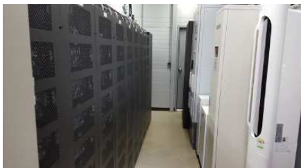
設置した蓄電システム
