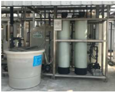
汚水再処理設備
