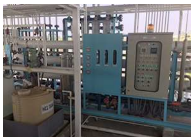
純水製造設備
