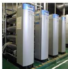
RO膜 ※ ユニット
