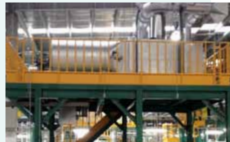
直燃脱臭装置
