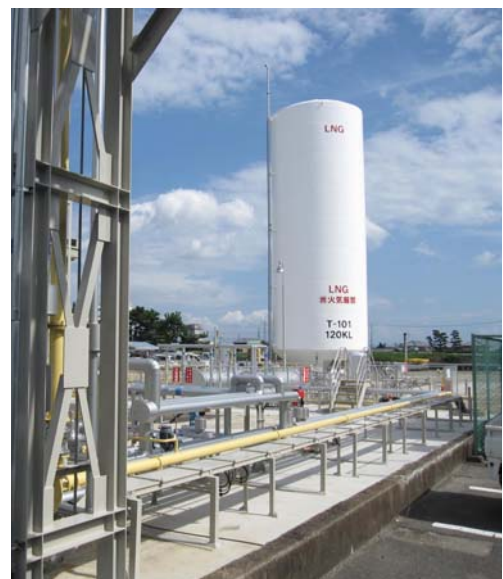
LNG サテライト設備
