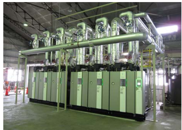
LNG ボイラー
