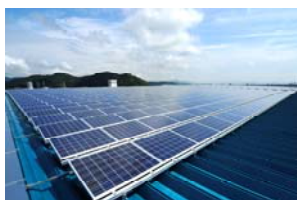
日清紡ペーパープロダク ツ(株)島田事業所 出力：250kW 設置：2010年9月
