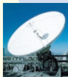
防災無線システム
