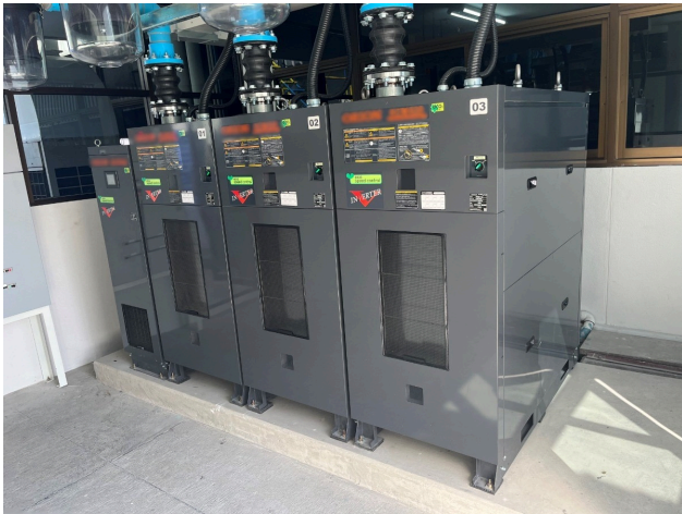
中央真空ポンプ
