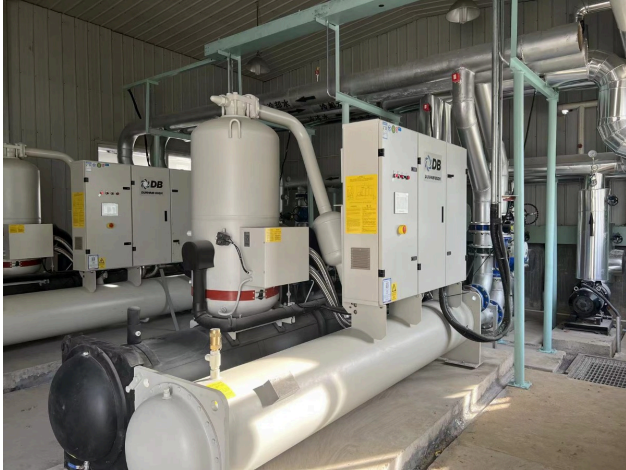
省エネ改造された空調設備
