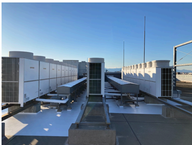
遮熱・断熱塗装後の空調室外機
