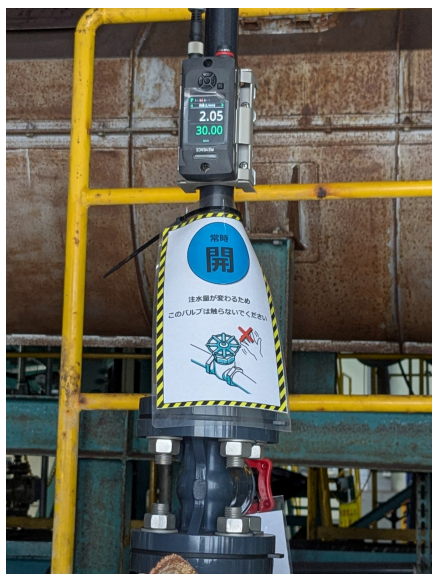
供給配管に追加した流量計
