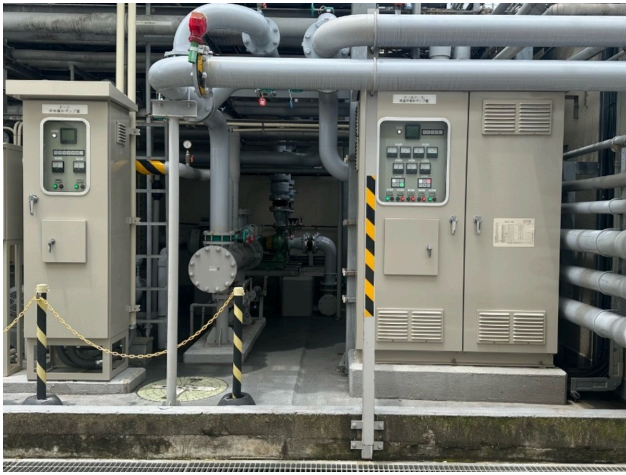
更新後の常温冷却水ポンプ盤
