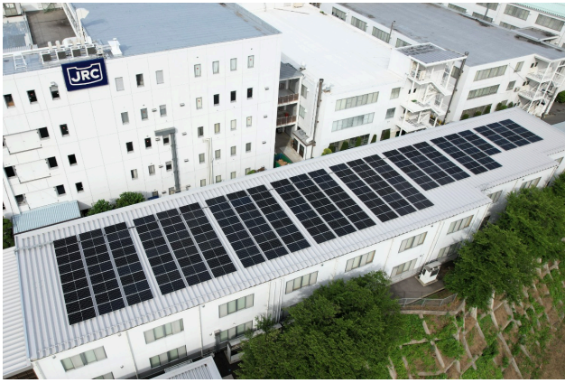
太陽光発電設備
