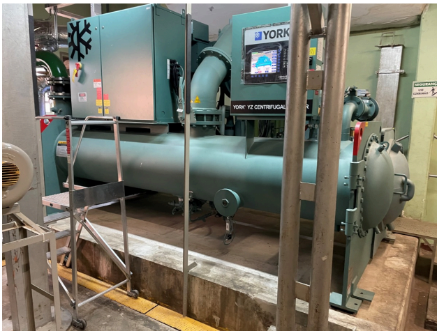
ノンフロン化冷凍機設備
