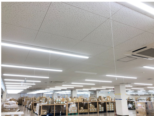
照明器具のLED化
