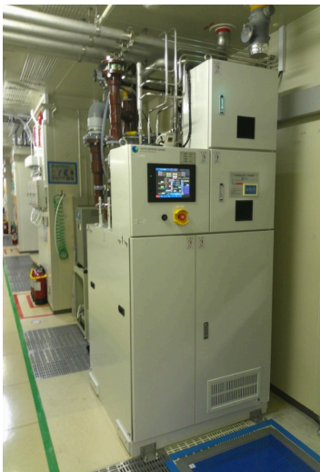
PFC等ガス除害装置
