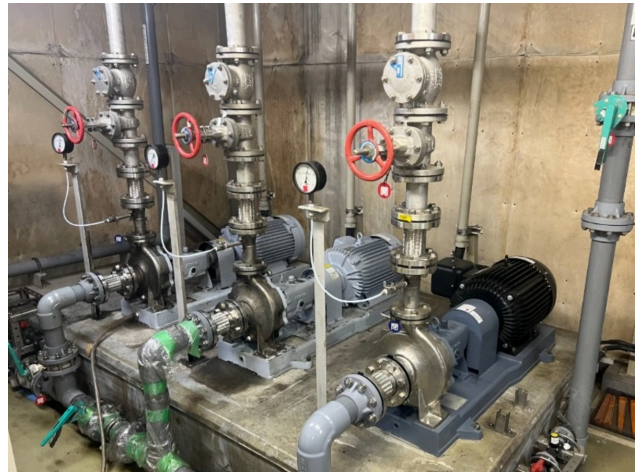
更新後のRO高圧ポンプ
